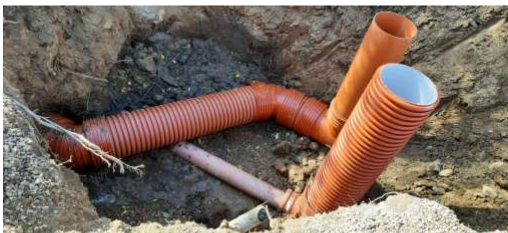
Rozdzielenie sieci kanalizacji sanitarnej i kanalizacji deszczowej na ul. Turystycznej w Lesku
