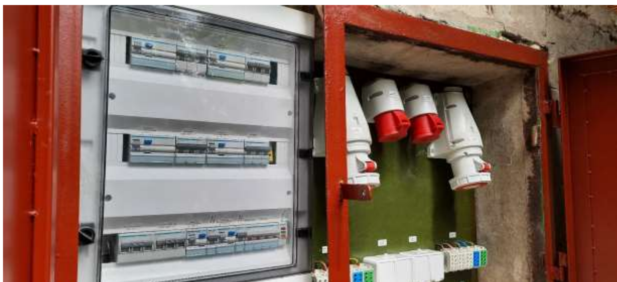
Modernizacja rozdzielni elektrycznej zasilającej scenę amfiteatru w Lesku
