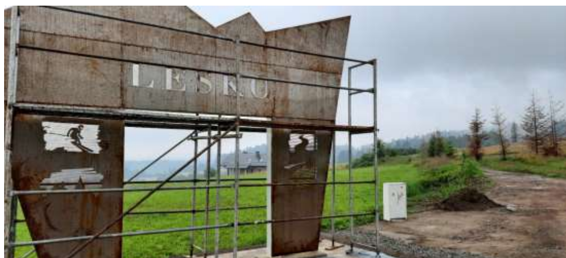
Budowa witacza z tarasem widokowym „Brama Bieszczad” na dz. nr ewid. 174 w miejscowości Postolów
